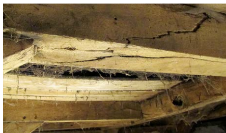
(5) Bruch im Stichgebälk des oberen Stockwerks (Westseite)
