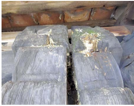
(7) Schwammbefall der Knaggen Ecke Südost oberes Stockwerk durch stetige Feuchtezufuhr. Ursache war ein defekter Dachziegel.
