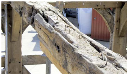
(4) Ein durch Feuchte völlig geschwächter Eichendeckenbalken aus dem oberen Stockwerk mit Befall mit Schadinsekten. Die Tragfähigkeit war nicht mehr gegeben.
