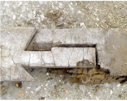
(6) Scherzapfen mit Zapfenschloss vom zweiteiligen Rähm im Erdgeschoss (Westseite) auf Zug beansprucht, unbrauchbar durch Schwammbefall mit Würfelbruch
